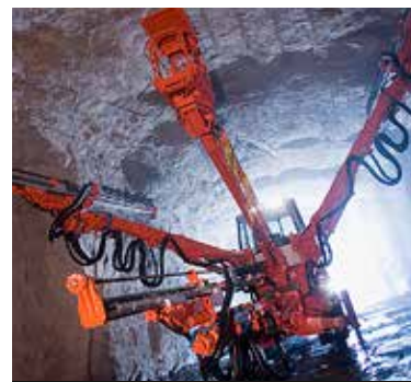
Två Sandvik DT1131i och två DT921i kommer att gräva världens längsta vägtunnel i.
